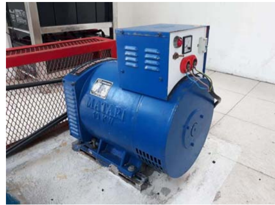
Gambar 11. Generator PLTMH kapasitas 10kW
