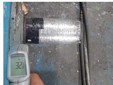
Gambar 4.10 Pengukuran Suhu Motor
