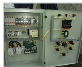
Gambar 9. Panel ATS dan AMF Panel ATS dan AMF merupakan instrumen kelistrikan
