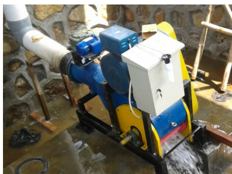
Gambar-2. Instalasi PLT- Mikrohidro, Palasari, Bogor
