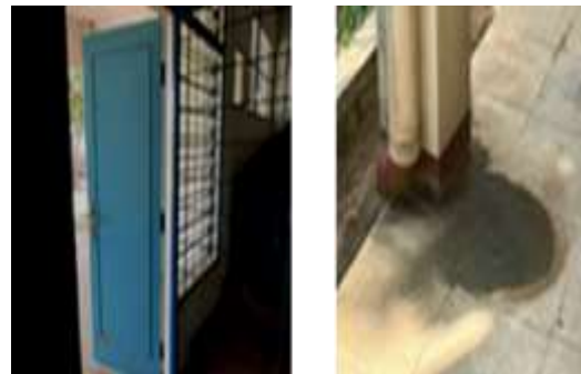
Gambar 7. Kondisi Pintu dan Lantai Koridor pada Gedung A, B, dan C
