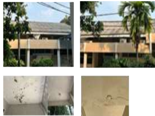
Gambar 3. Struktur Dan Kerusakan Plafon Ekspos Pada Gedung A,B, Dan C
