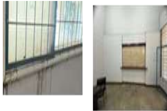
Gambar 6. Kerusakan dinding pada Gedung A, B, dan C
