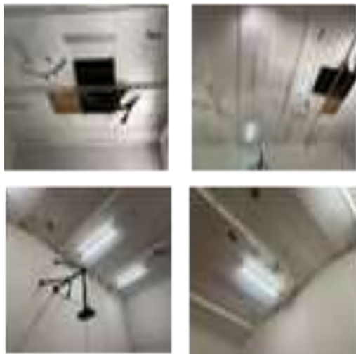
Gambar 5. Kerusakan Plafon pada Gedung A, B, dan C
