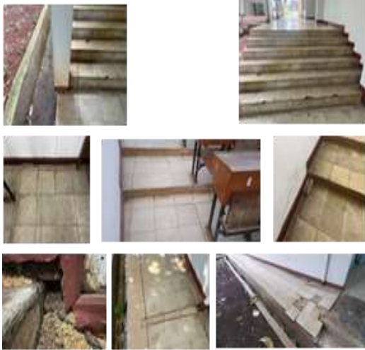
Gambar 4. Kerusakan lantai pada gedung A,B, dan C (Sumber: Dokumentasi Peneliti,2024)
