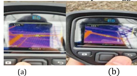
Gambar 13. Nilai Sebelum Perbaikan (a). Contact Finger DS Rel 2 Fasa S (b). DS Line Fasa S
