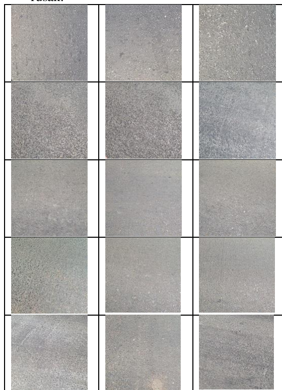
Gambar 8. Sampel jalan aspal tidak rusak.
