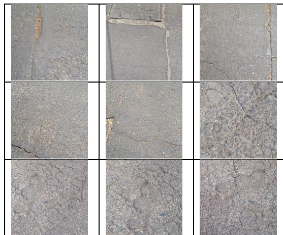
Gambar 7. Sampel jalan aspal rusak.
