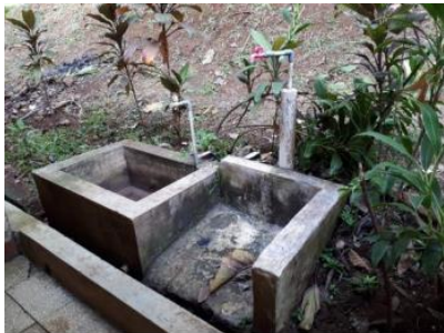
Gambar Foto 7: Kran Air yang sudah Rusak Sumber : Dokumentasi Pribadi 2019
