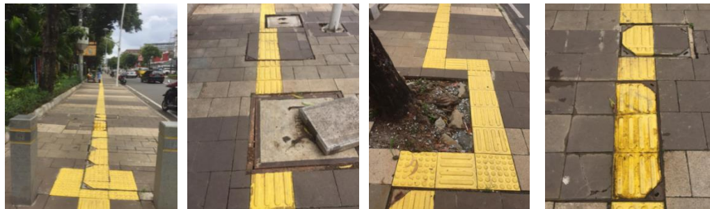
Gambar 14. . Kondisi sirkulasi dan kerusakan guiding block pada jalur pedestrian
